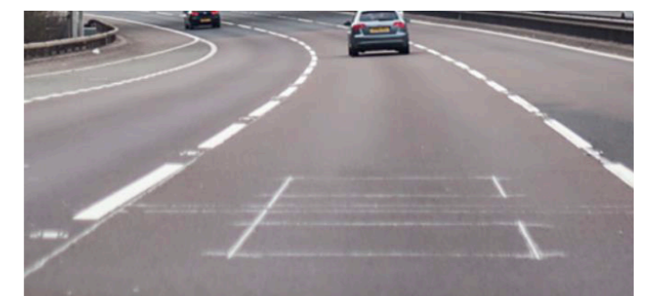
Boucle inductive en saignée dans la chaussée
